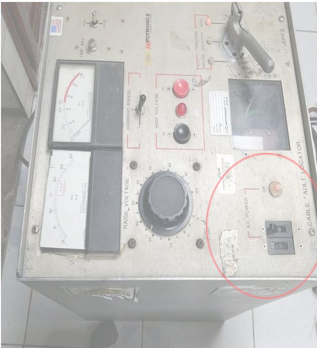
Figura 1: Equipo con el interruptor original
