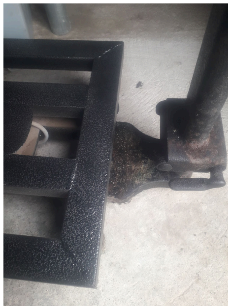
Presencia de Óxido
